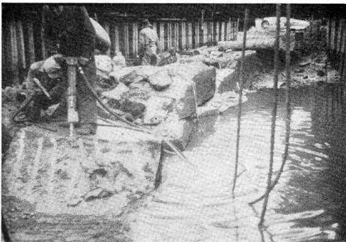
Bassin Hansa à Anvers. Vue du mur de quai effondré.
